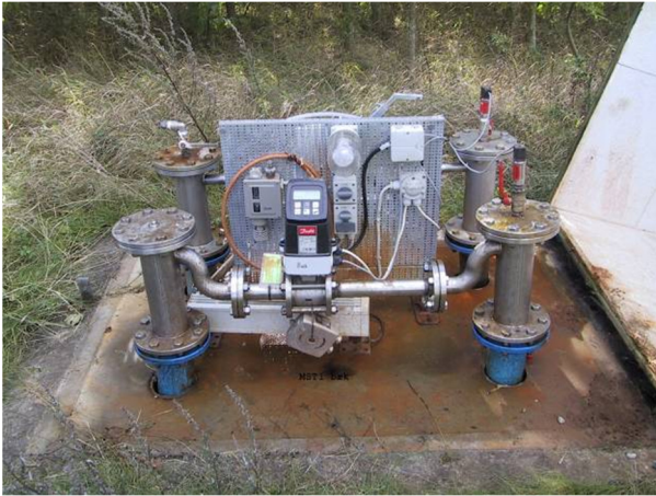
Pumpeanlæg til oppumpning og styring af forurenset vand
