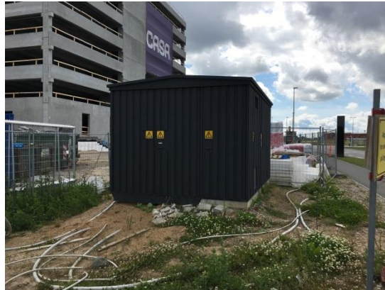
Figur 3.7: Transformerstation i terræn for tilslutning af P-plads solceller
