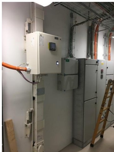
Figur 3.6: Kanalskinne samt tilslutningsboks i teknikrum
