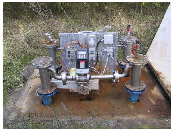
Pumpeanlæg til oppumpning og styring af forurennet vand
